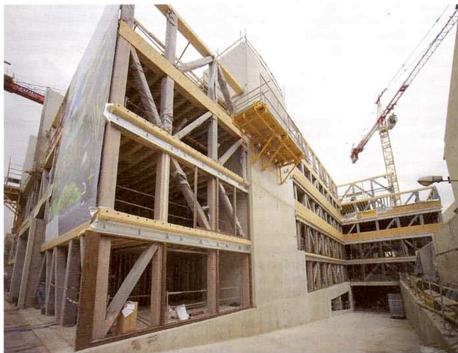
L'immeuble E+ pour l'INPI : une structure bois avec dalles collaborantes et façades entièrement vitrées. Le travail du BET a consisté à trouver l'équilibre entre l'isolation et la gestion des apports thermiques.
